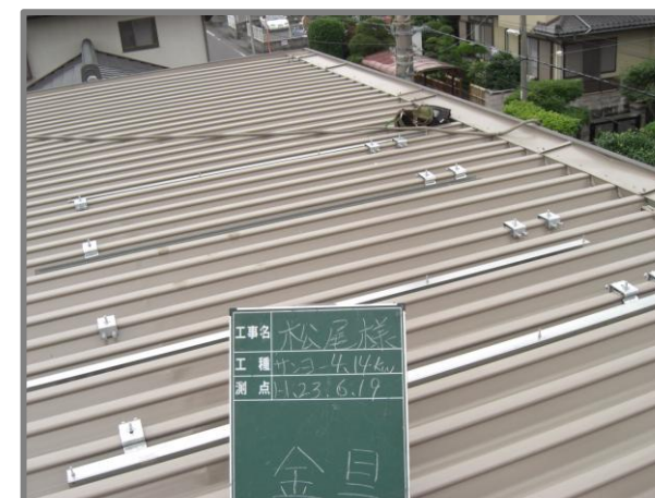
金具設置状況
