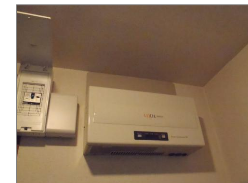
パワーコンディショナー設置状況
