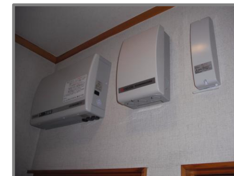
パワーコンディショナー設置状況
